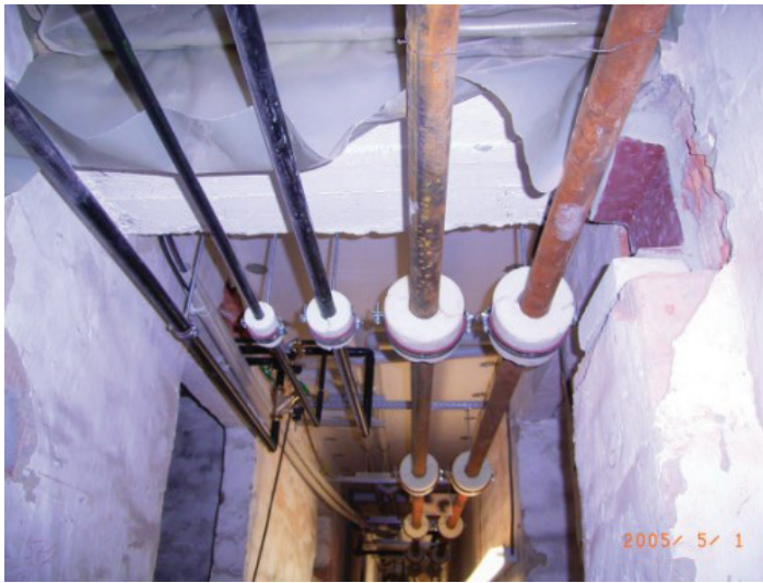
Fot. 9. Instalacja c.w.u. i c.o. przed wykonaniem ocieplenia; widoczny specjalny system mocowania przez twardą izolację piankową eliminujący ryzyko powstania przerw i pocienienia warstwy izolacji Źródło: Fundacja Poszanowania Energii.
